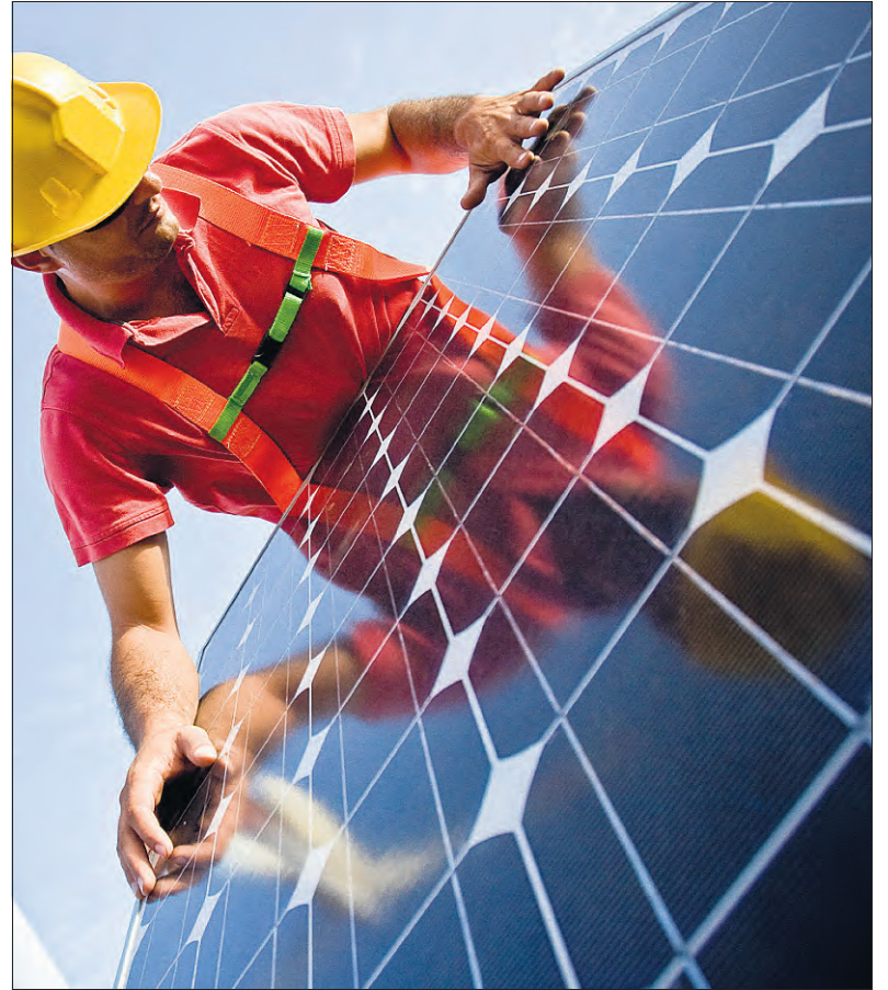
Eine sorgfältige Montage soll die Überhitzung der Fotovoltaik-Module verhindern. Hitze reduziert nämlich die Stromausbeute.
